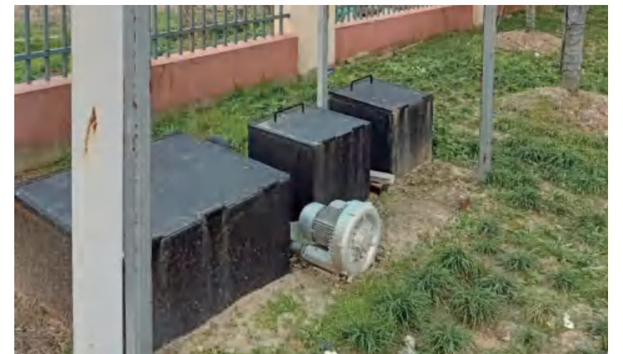
华润衢州医药地理式污水处理系统
