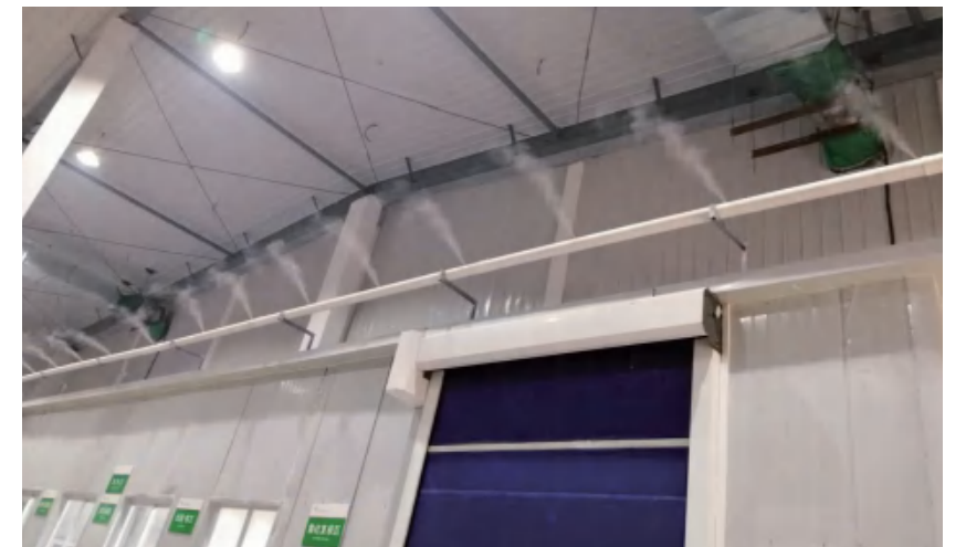
华润辽宁医药库房加湿节电设备
